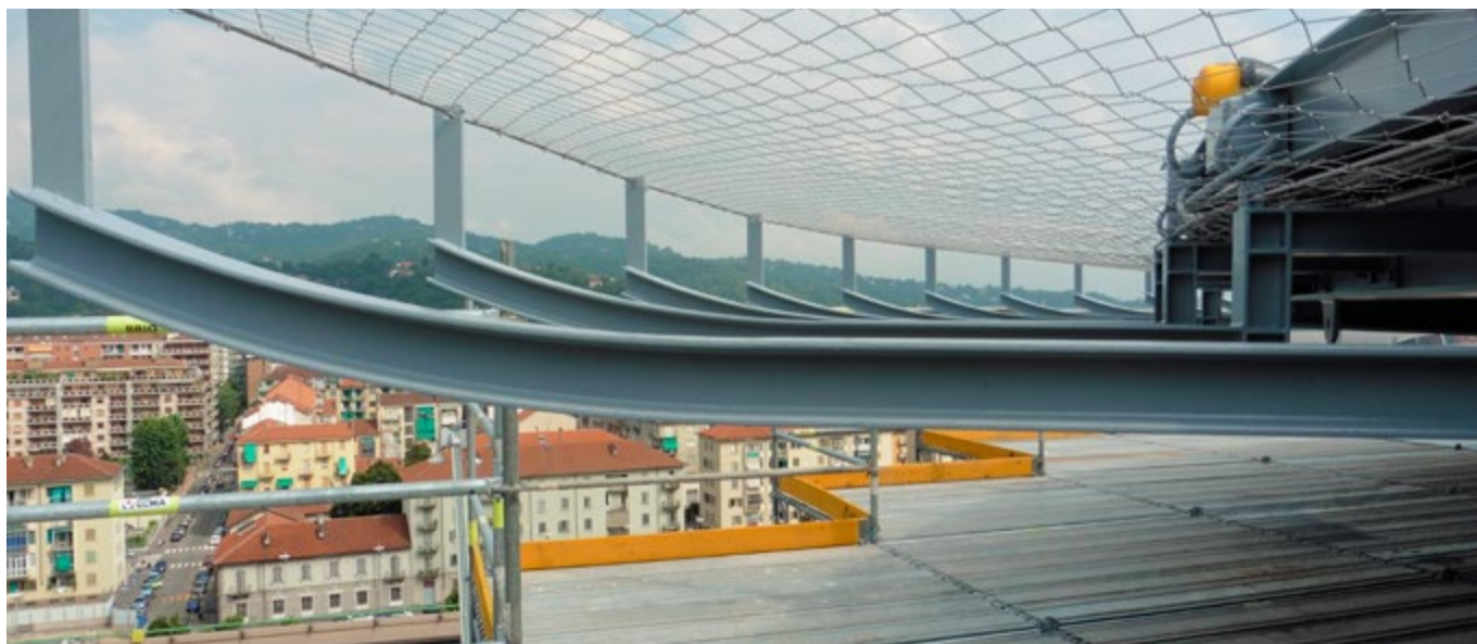
Rete anticaduta installata a sbalzo.
